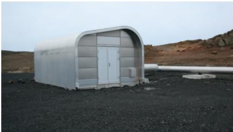
Mynd 3-2 Borholuhús við Reykjanesvirkjun.
